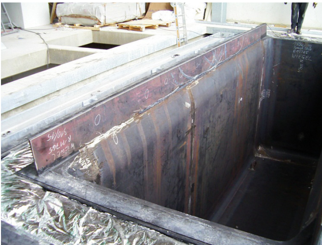
Ofen mit eingesetztem Verzinkungskessel (noch leer)
