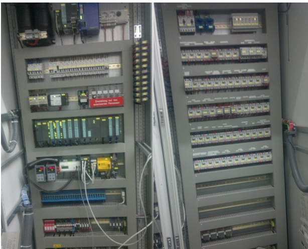
Schaltschrank der Ofensteuerung
